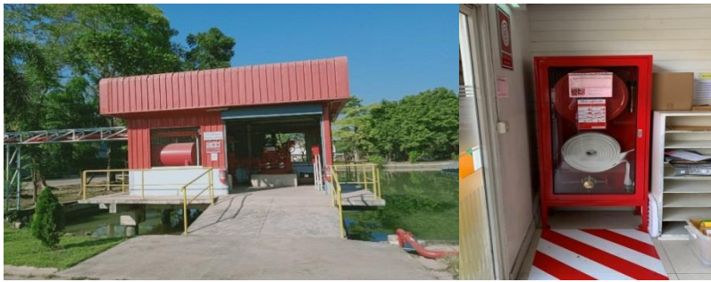
รูปอาคารปั้มน้ำดับเพลิงและตู้หัวจ่ายน้ำและตู้หัวจ่ายน้ำต่างๆ
