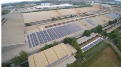
ระบบ PV Solar Rooftop ขนาด 1.8 MW ที่โรงงานนิคมหนองแค
