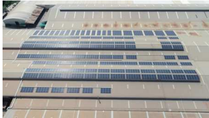
ระบบ PV Solar Rooftop ขนาด 0.9 MW ที่โรงงานหนองแค1
