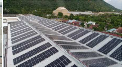
ระบบ PV Solar Rooftop ขนาด 2.0 MW ที่โรงงานหินกอง
