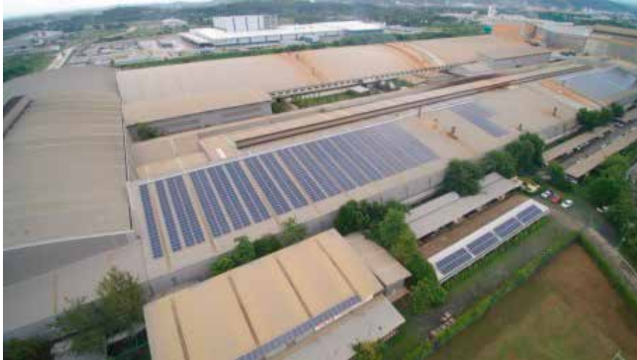
ระบบ PV Solar Rooftop
