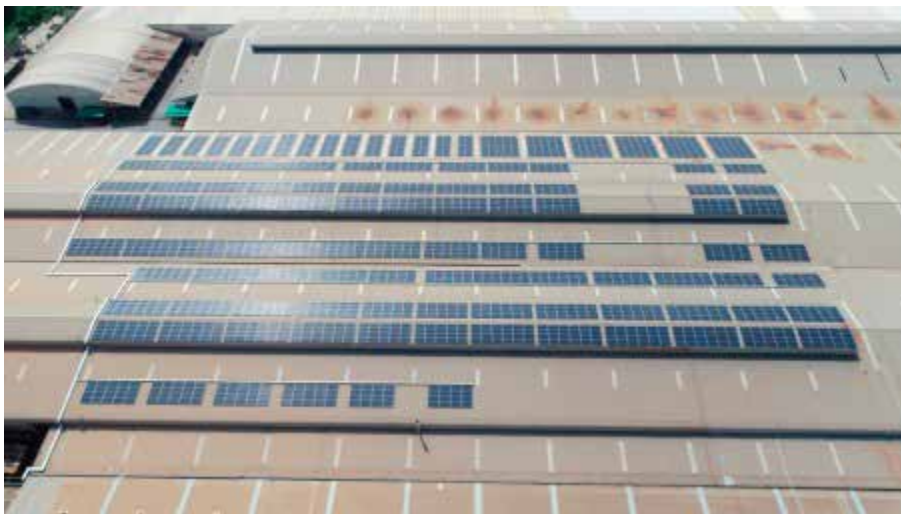
ระบบ PV Solar Rooftop
