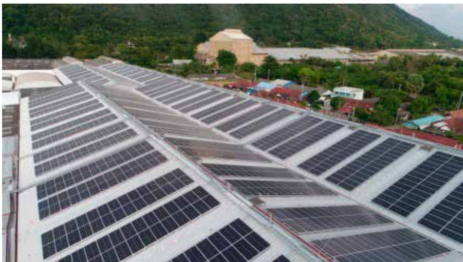
ระบบ PV Solar Rooftop
