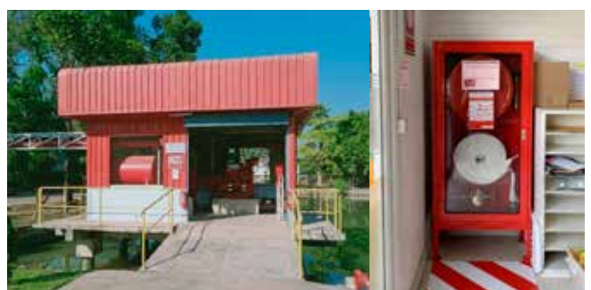
รูปอาคารปั้มน้ำดับเพลิงและตู้หัวจ่ายน้ำ
