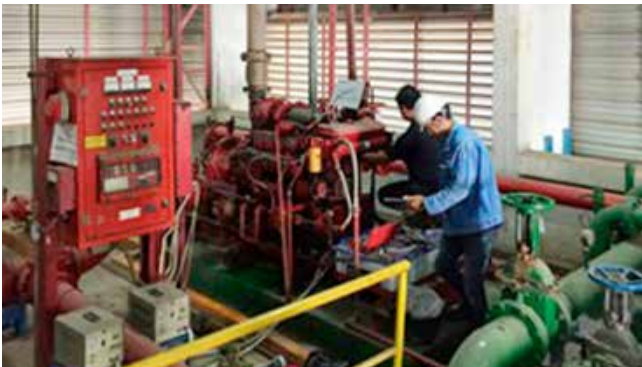
การทดสอบป้อนน้ำดับเพลิง เครื่องสูบน้ำ หรือการตรวจสอบถังดับเพลิง
